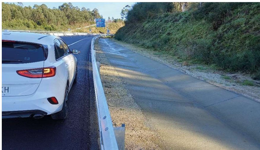
Figura 8. No sólo el diseño de la cuneta no es adecuado sino que, además, "se protege" con una barrera.
