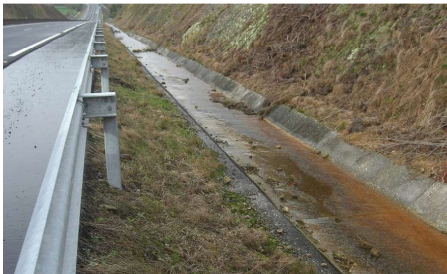
Figura 9. La barrera se coloca para proteger una cuneta absurdamente grande y profunda (obsérvese la escasa marca que el agua ferrica ha dejado en la cuneta). Con el gran ancho existente entre la barrera y el talud hubiese sido muy fácil un rediseño “amigable” con una cuneta de seguridad 10H:1V
