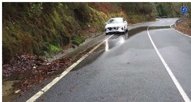
Figura 23. Sumidero de drenaje transversal en cuneta, tapado por las hojas. El agua cruza la carretera.
