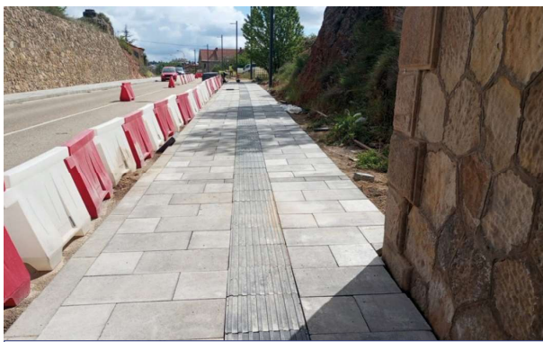
Figura 16. Pavimento en Carretera de Madrid
