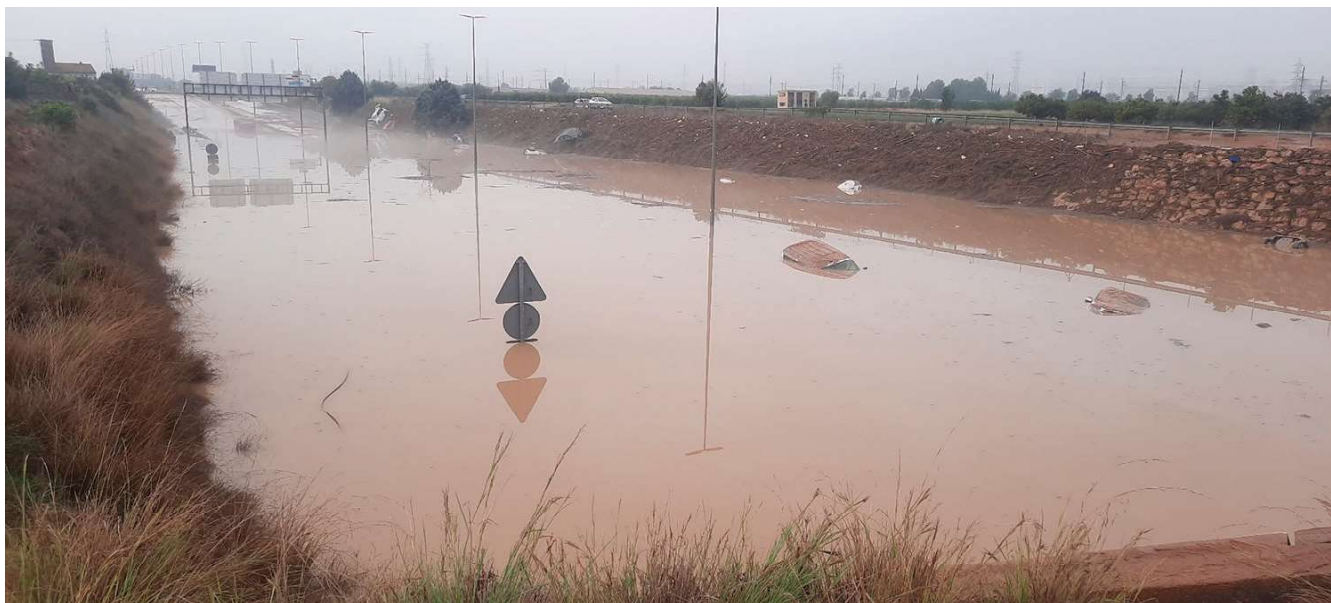
DANA de Valencia: Autovía CV-33 en Torrente (Consellería de Medio Ambiente, Infraestructuras y Territorio de la Generalitat Valenciana)
