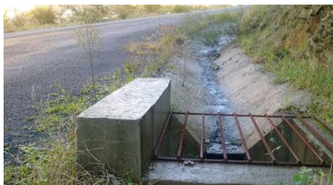
Figura 20. Todo peligroso: cuneta trapezoidal, con pozo sobreelevado y rejilla endeble para evitar la caída en el pozo.
