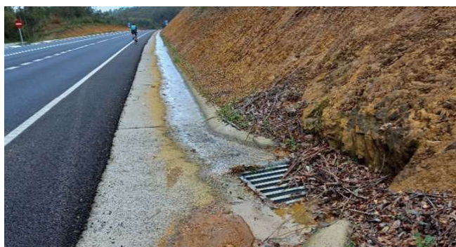
Figura 22. Mejor aún si se puede retranquear el pozo y que quede la zona de seguridad de la cuneta libre
