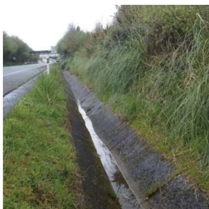
Figura 2. Cuneta triangular con riesgo de vuelco (antes)
