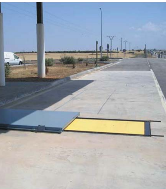
Figura 5. Detalle de la protección antivandática de la báscula de pesaje estático o dinámico a baja velocidad de la Estación de Pesaje de la A-2 en provincia de Guadalajara. Fuente: "Eptisa".
