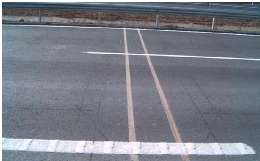
Figura 2. Aspecto final de la zona de la carretera en dónde se localiza la báscula dinámica. Fuente: "TECBAS".
