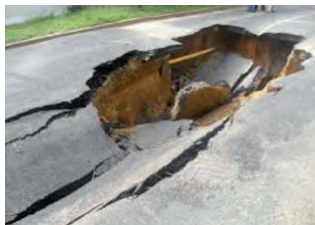
Foto 6. Colapso y hundimiento calzada
