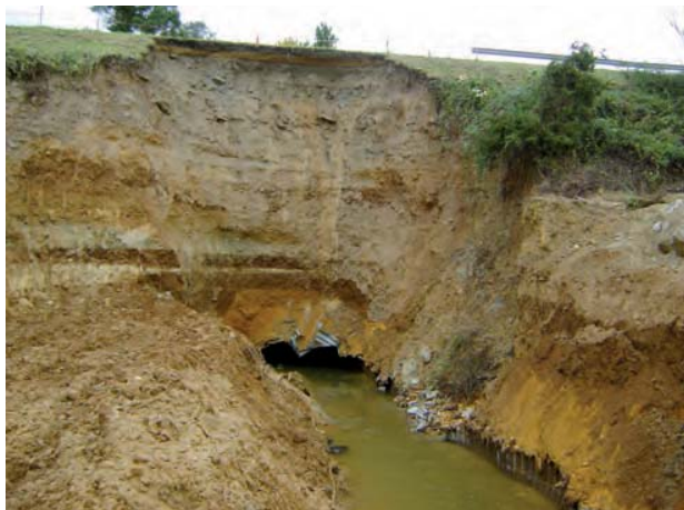
Foto 31. Colapso de ODT
