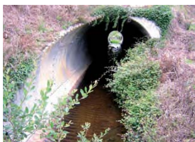
Foto 19. Síntomas de corrosión
