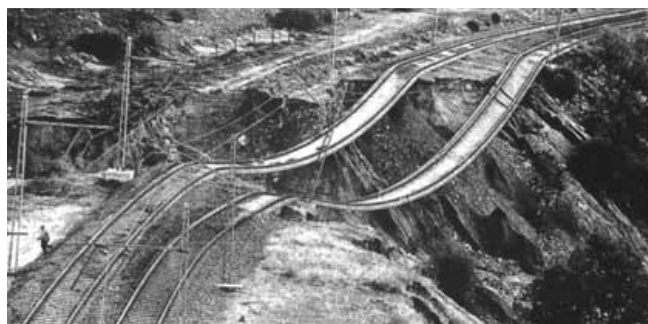
Figura 28. Deslizamiento de un terraplén sobre "margas del Guadalquivir" en Almodóvar del Río (ABC)
