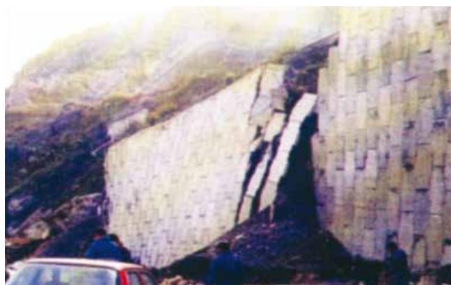
Figura 30. Ruina de un muro de tierra armada en la bajada de Granada a Motril (Lluvias de 1997)
