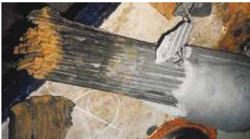
Figura 29. Detalle de la falla del tirante roto en Zárate
