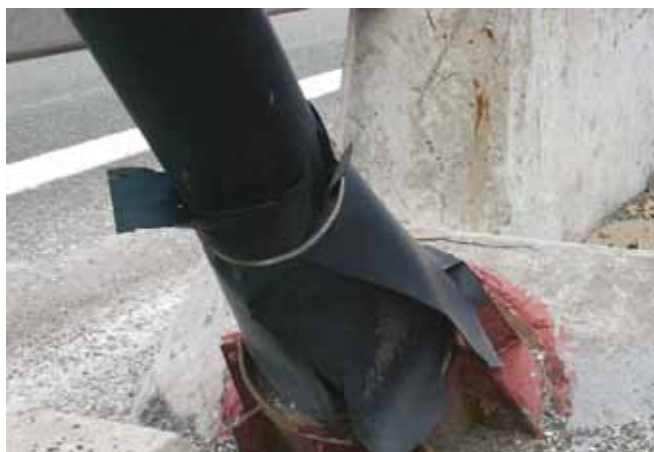
Figura 7. Daños en faldón de conexión entre vaina y tubo guía
