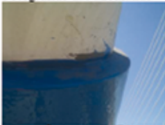
- Corrosão local / ENRA1 Data:05/08/2008
