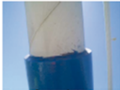
- Alteração do mástico de impermeabilidade / MASC2 Data:05/08/2008
