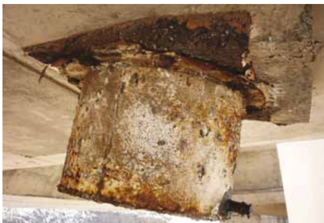
Figura 3. Corrosión en el exterior del capot
