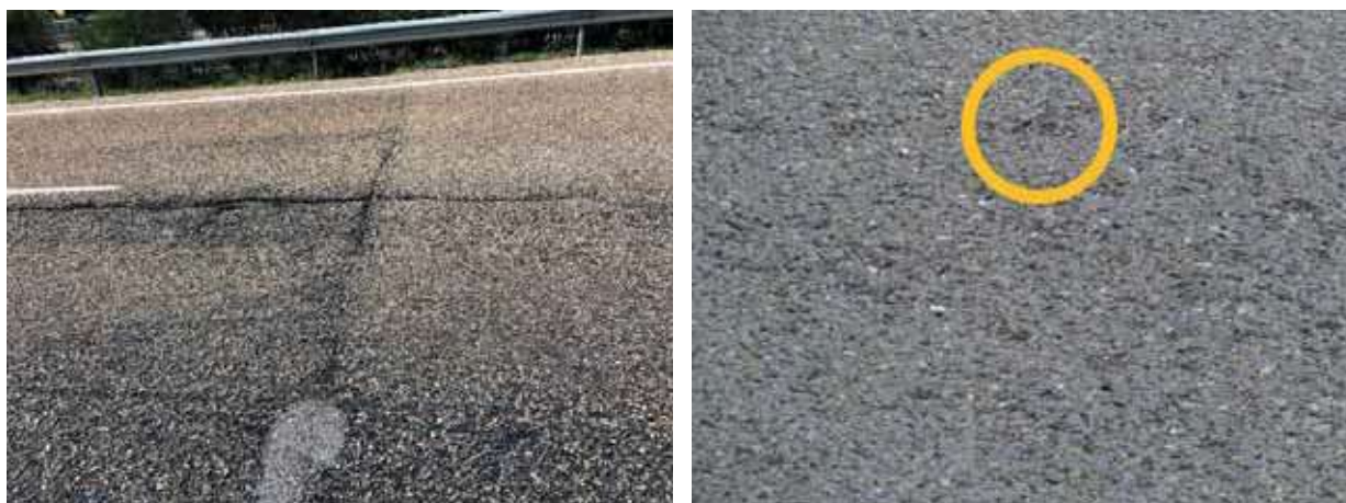
Figura 33 y 34. Pérdida de gravilla en capas de rodadura drenantes
