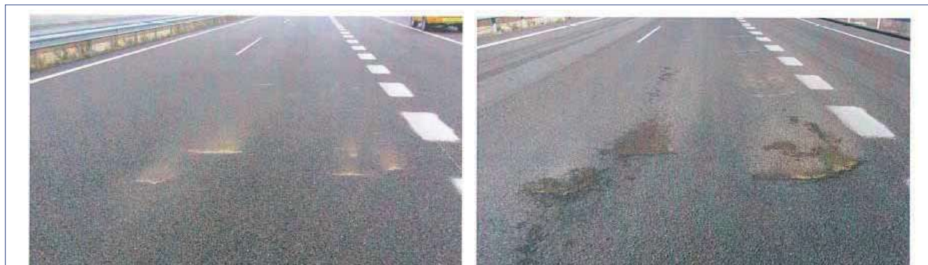
Figura 31 y 32. Ascenso de finos del suelocemento a la superficie de rodadura
