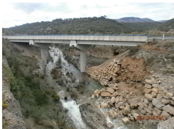
Figura 10. Fotografía del 6 de marzo de 2013, unas tres horas después del paso del pico de la avenida: observese la caída del muro de escollera de protección del estribo y la poza de socavación en la margen contraria
