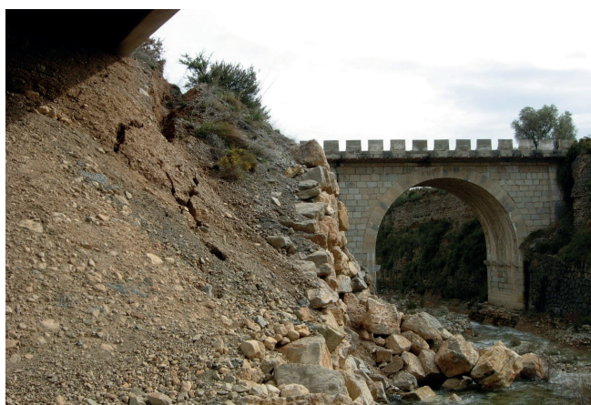
Figura 11. Fotografía del 6 de marzo de 2013, unas tres horas después del paso del pico de la avenida: caída del muro, grietas y asientos en cono de tierras del estribo norte del viaducto de 2002 (a la izquierda) y erosión en estribo sur del puente de 1940 (a la derecha de la imagen), que a partir de entonces empezó a funcionar como cauce de aguas bajas
