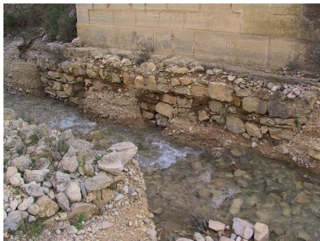
Figura 13. Imagen del 12 de marzo de 2013: seis días después del paso de la avenida; socavación del cimiento del estribo S del puente de 1940 y generación de cauce de aguas bajas en el nivel de gravas con cementación calcárea, de entre 60 y 75 cm de profundidad
