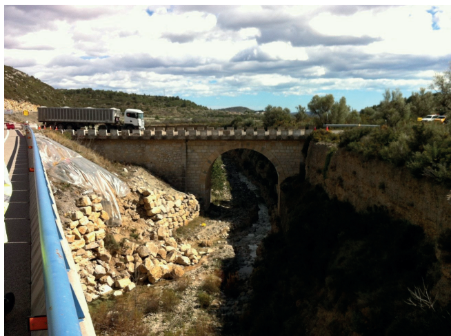
Figura 12. Imagen del 12 de marzo de 2013: seis días después del paso de la avenida, el cauce vuelve a estar casi seco, el tráfico se ha desviado por el puente de 1940 y permanece la lámina impermeable para evitar la entrada de lluvia por las grietas en el cono de tierras del viaducto de 2002
