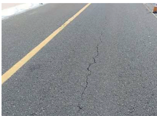
Figura 9. Reflejo en el pavimento de una de las grietas existentes en el tablero (Estructura de la carretera SG-20)
