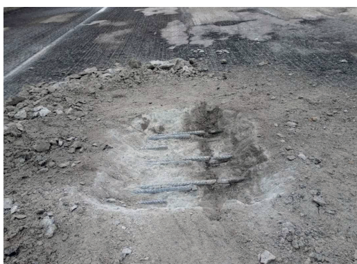
Figura 13. Barras seccionadas en la estructura de la carretera SG-20
