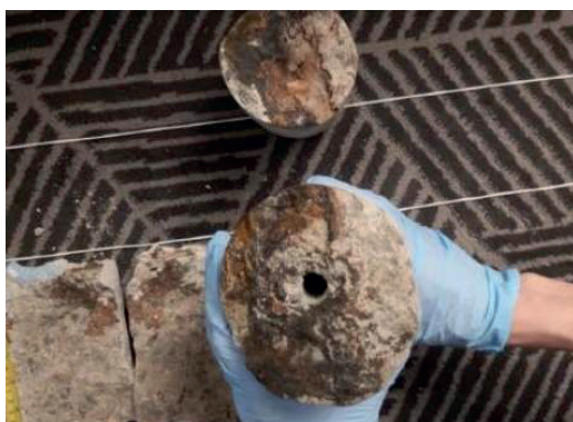
Figura 14. Aspecto del óxido observado en uno de los testigos extraídos en la traza de la fisura para su examen visual
