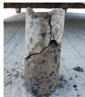
Figura 10 – Fracturación interior de la masa de hormigón en uno de los testigos extraídos en la estructura de la carretera SG-20ra SG-20)
