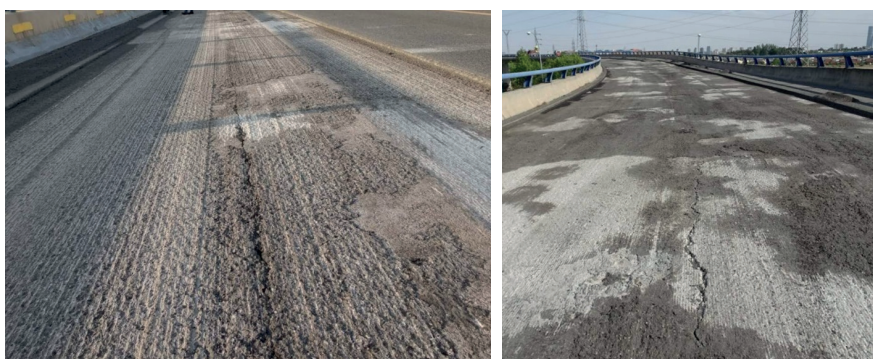
Figura 8. Fisura longitudinal observada en la cara superior del tablero (A la izquierda, estructura de la carretera SG-20; a la derecha, estructura del Nudo de Colmenar)
