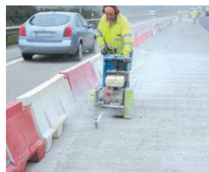
Foto 16. Serrado de la junta longitudinal entre carriles.
