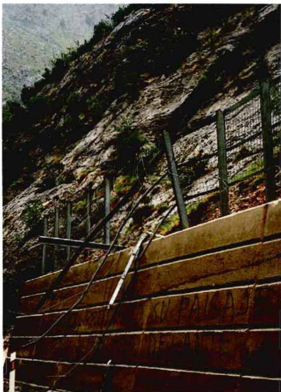
Pantalla estática destruida por impacto de piedras.
