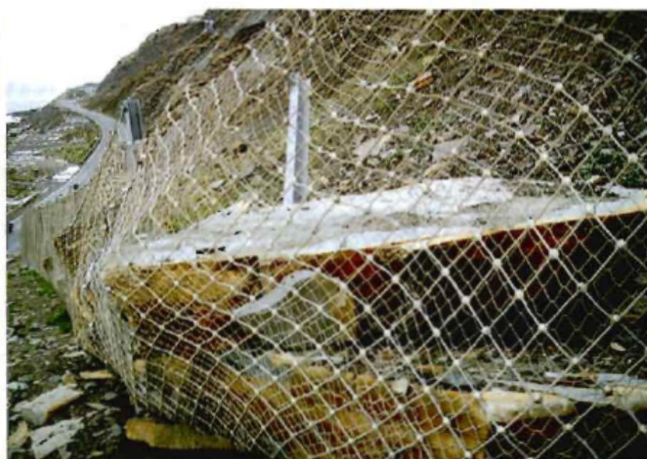
Desprendimiento detenido por una malla dinámica.
