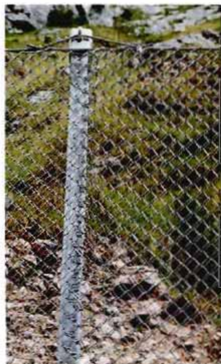
Detalle de la unión y los cables al poste de la pantalla dinámica.
