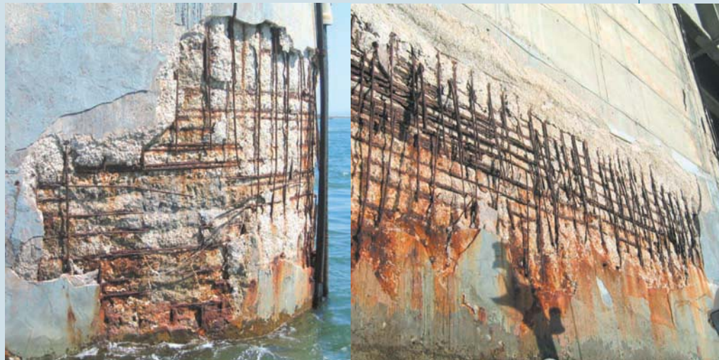
Detalle de daños en zona marina.
