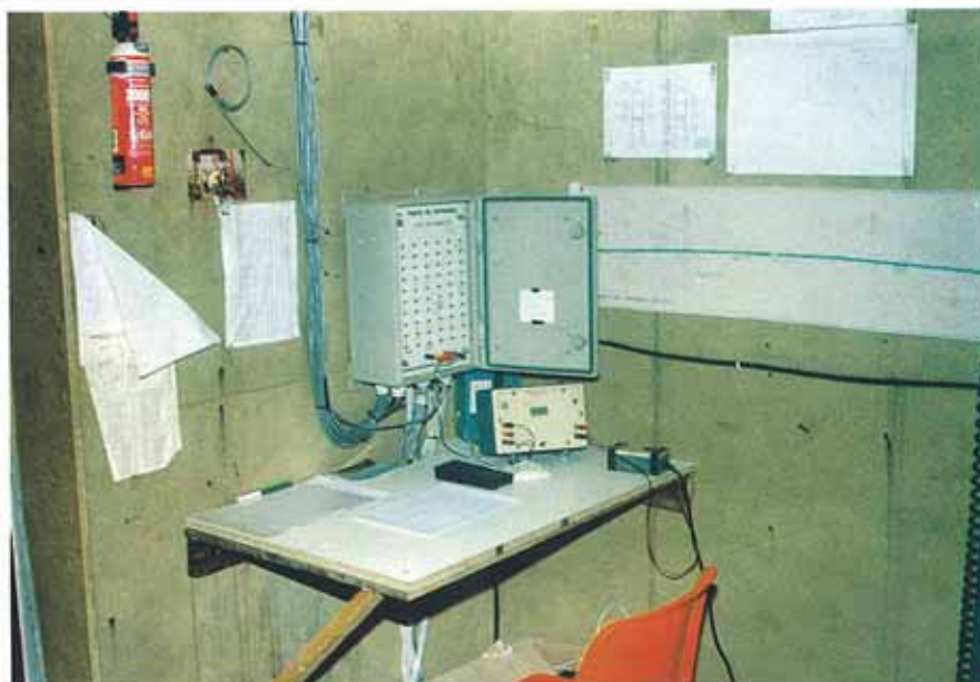
Puente del Centenario (Sevilla). Equipo de adquisición de datos de temperatura.
