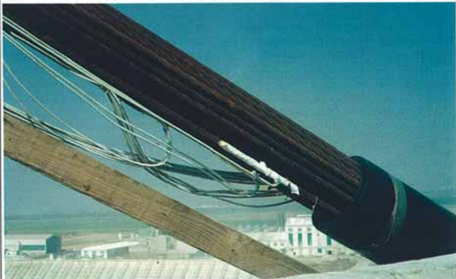
Puente del Centenario (Sevilla). Detalle de bandas extensométricas en tirantes.
